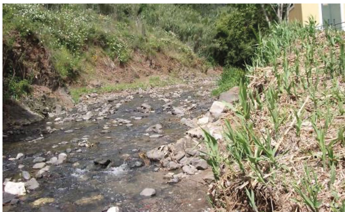
Linhas de água em mau estado
