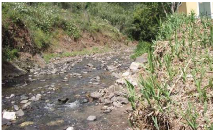
Linhas de água em mau estado
